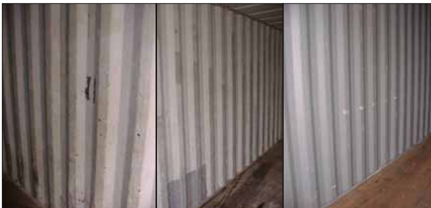
Abb. 32: Ungereinigte Wände von Containern unterschiedlichen Baujahrs
